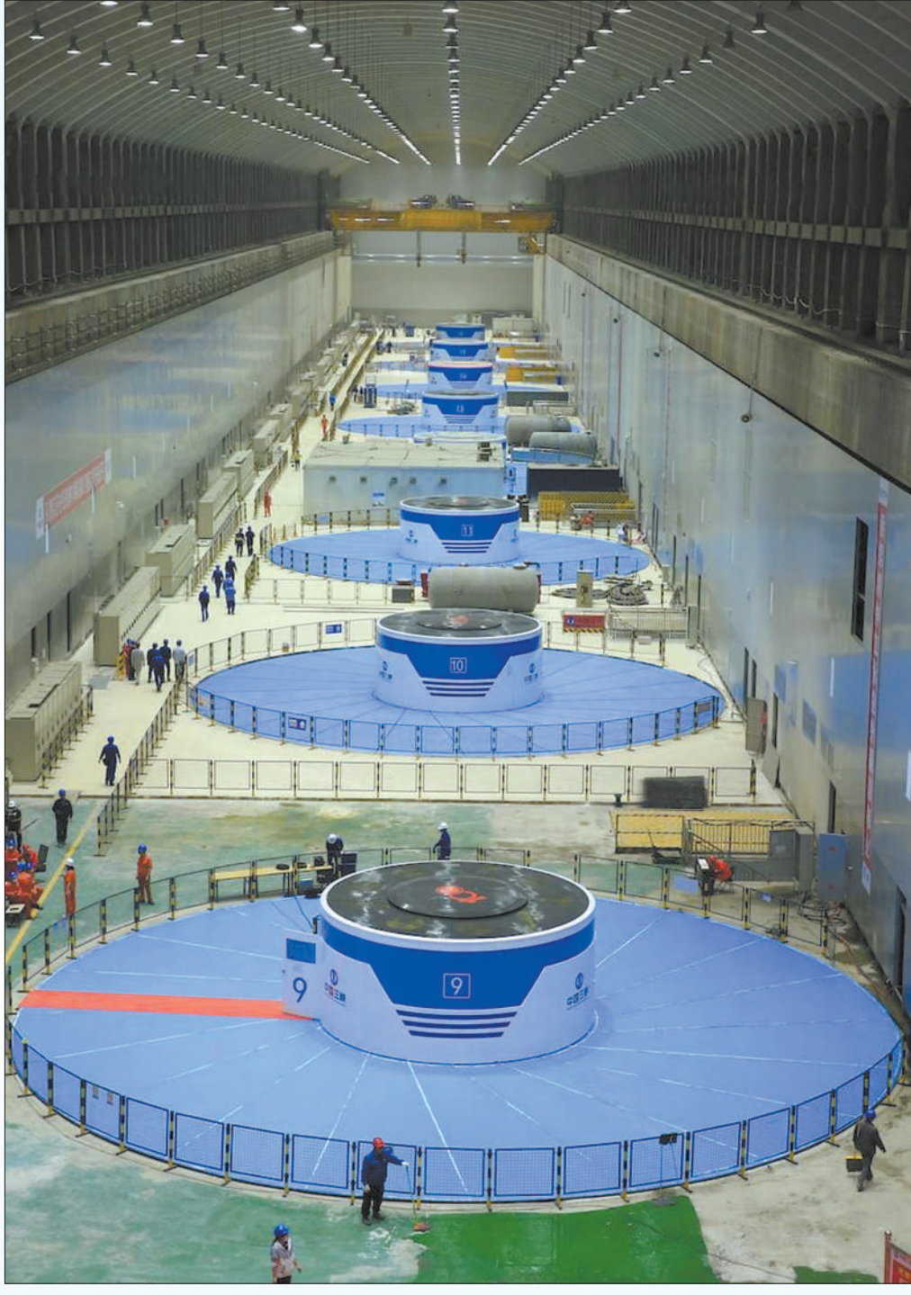
白鹤滩水电站共安装16台我国自主研发、全球单机容量最大的百万千瓦水轮发电机组,左右两岸各布置8台,是当今世界在建规模最大、技术难度最高的水电工程。图为白鹤滩水电站右岸地下厂房。 闫科任摄(影像中国)
