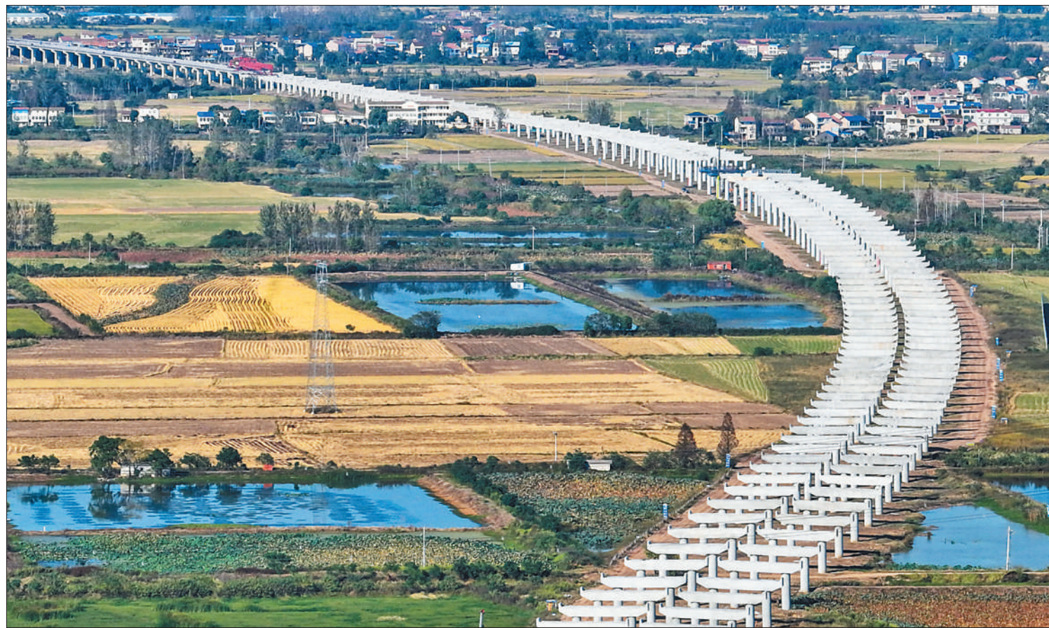
10月11日，孝汉应高速公路湖北省孝感市云梦县区域施工现场，项目建设有序推进。孝汉应高速公路全长约34公里，该项目的建成将优化区域高速公路网、促进沿线城镇及产业发展。胡学军摄（人民视觉）
