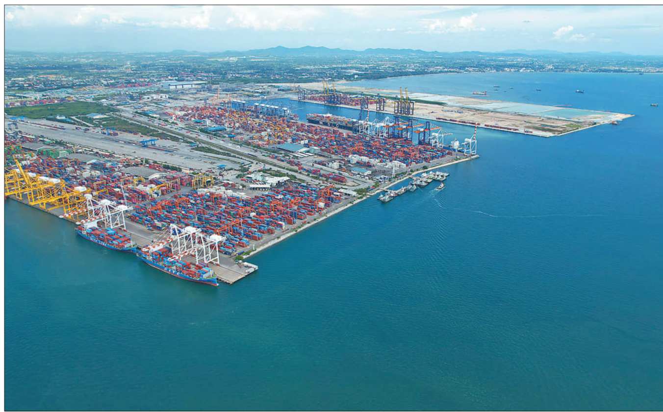
林查班港是泰国最大的集装箱深水港口和物流枢纽，承担了泰国大量进出口业务。目前，该港口正在进行三期扩建，中国铁建承建其中部分海事工程，包括疏浚吹填、护岸施工、地基处理等。项目建成后，林查班港将有效提升运能，成为“一带一路”沿线的重要港口，为泰国发展进出口贸易发挥重要作用。图为港口扩建工作有序推进。
