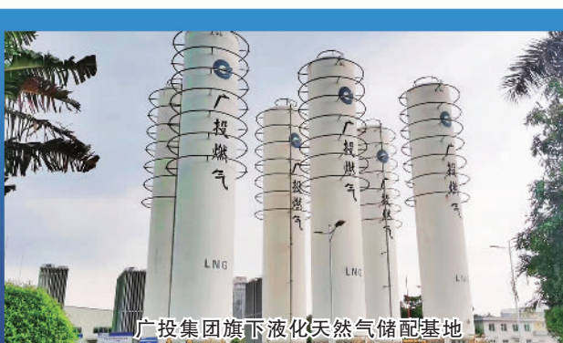
广投集团旗下液化天然气储配基地
