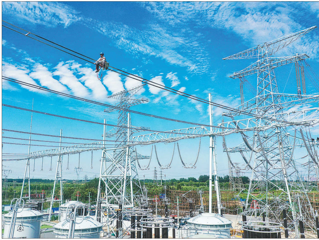
作为北京“一核两翼”中的重要一翼，北京城市副中心大力打造安全高效、互联互通的绿色智能电网，加快建设通州北500千伏输变电工程等一批骨干工程。工程完工后，副中心电网供电可靠性和清洁能源消纳能力都将得到进一步提升。图为北京电力工程公司工人在通州北500千伏输变电工程现场施工。 本报记者 贺勇摄
