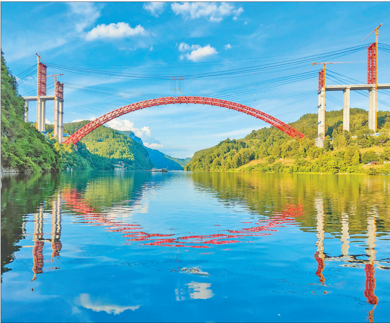
目前，贵州省德余高速乌江特大桥建设推进顺利，即将合龙。乌江特大桥是德江(合兴)至余庆高速全线关键控制性工程，全长1834米。大桥建成通车后，将推动乌江沿线资源的开发与利用，助力长江经济带发展。图为8月10日拍摄的建设中的乌江特大桥。
