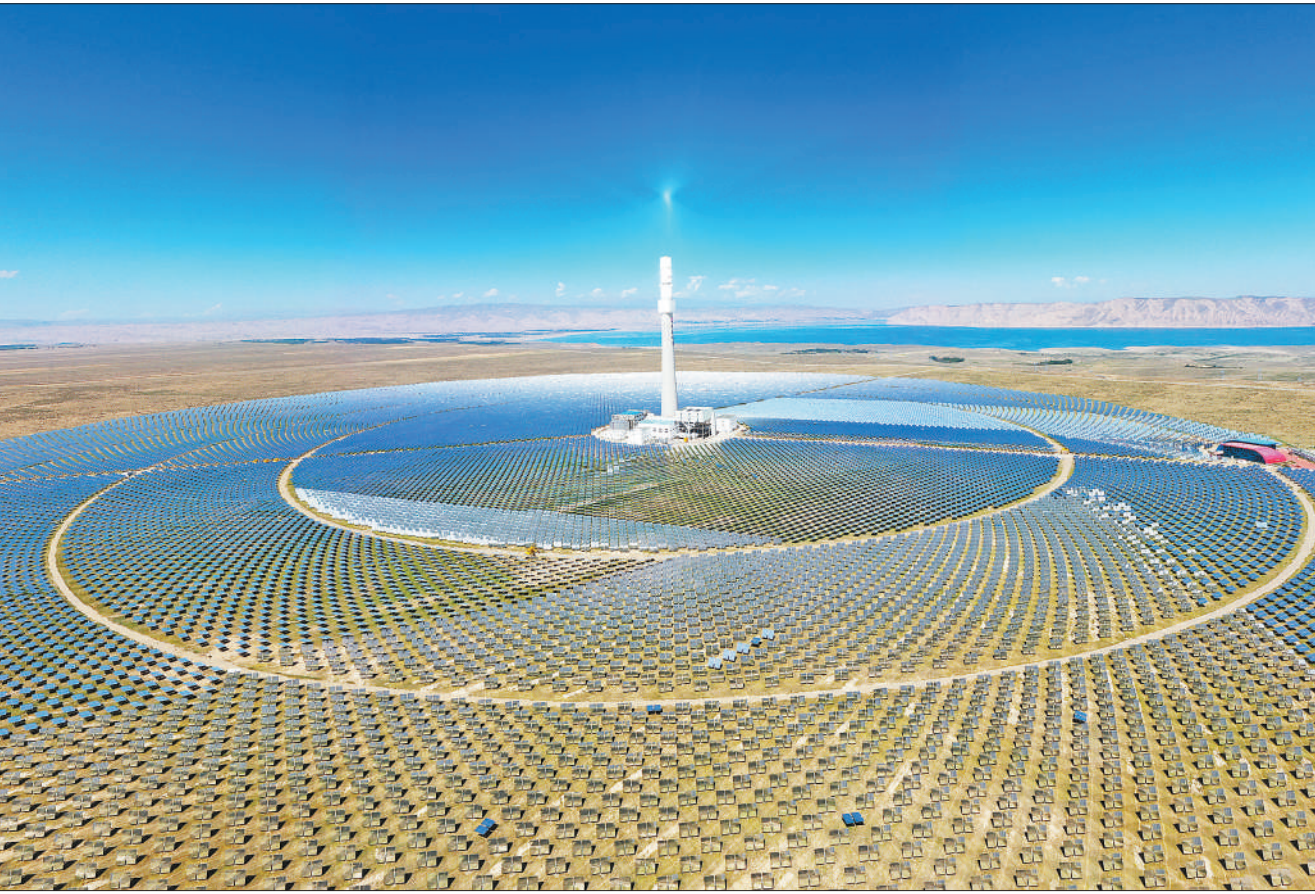
图为近日拍摄的青海省海南藏族自治州太阳能生态发电园区内的50兆瓦熔盐塔式光热电站。目前,新型储能熔盐塔式光热发电技术应用在国内日趋成熟,助力实现“双碳”目标。
