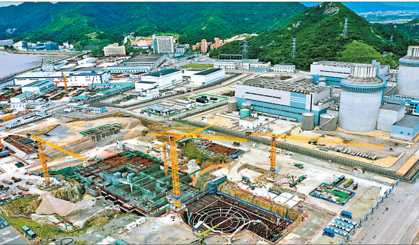
6月28日,国家重大能源项目——中核集团三门核电二期工程正式开工,将建设两台百万千瓦级核电机组,单台机组额定容量为125.1万千瓦,设计运行寿命60年。建成投产后,2台机组年发电量可达200亿千瓦时,将有力推动浙江省产业结构和能源结构优化,保障华东电网和区域能源供应安全。图为三门核电二期工程现场。 侯邦军摄(影像中国)
