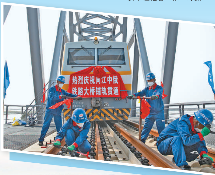
▼同江中俄铁路大桥位于中国黑龙江省同江市与俄罗斯下列宁斯阔耶市之间,桥梁全长7194米,设计运营时速100公里、年过货能力2100万吨。图为2021年8月17日,工人在同江中俄铁路大桥施工现场进行施工。 新华社记者 张涛摄
