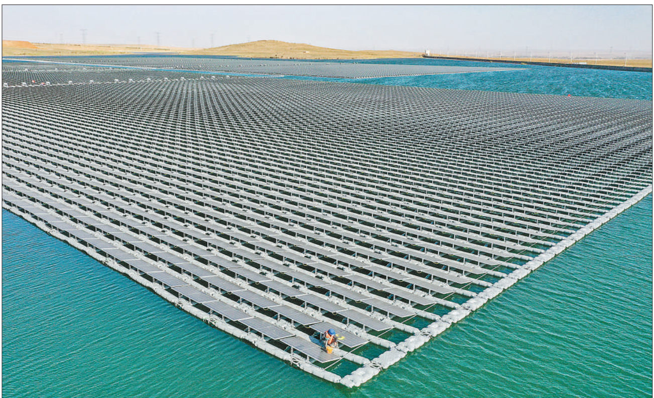
在宁夏灵武市马家滩镇的一处矿并疏干水聚集湖湖面上,一片片光伏板排列整齐。这是国家能源集团宁夏电力公司宁东电厂3x5.98兆瓦漂浮分布式光伏发电项目,日前该项目施工已进入收尾阶段。据了解,该项目共占用湖面面积300亩,项目总装机容量17.94兆瓦,是当地推动能源绿色低碳转型的重要举措。 图为6月17日拍摄的位于矿并水水域的漂浮光伏电站。 新华社记者 王 鹏摄
