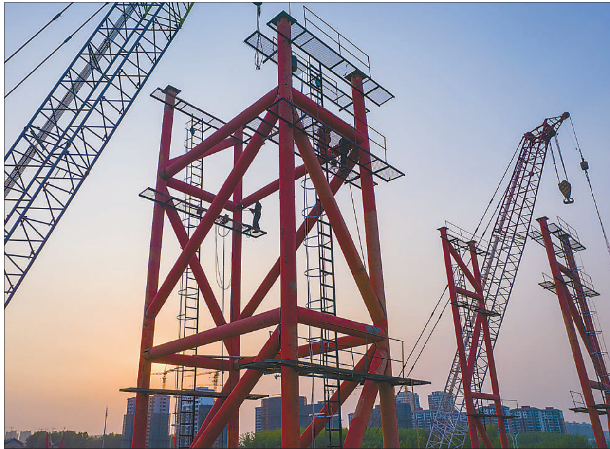
6月5日,在江苏省宿迁市跨京杭运河大桥施工现场,工人正在安装大桥拱肋支架。跨京杭运河大桥是宿迁市北京路快速化改造工程之一,建成后 will 大幅提高通行效率。徐江海摄(影像中国)
