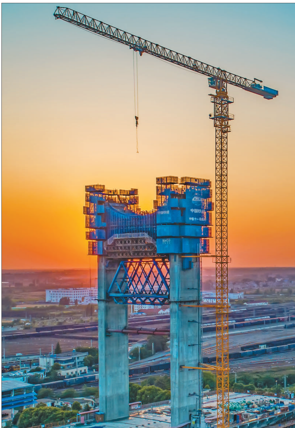
5月16日，湖北省襄阳市环线提速一期工程襄阳北编组站大桥建设取得关键性进展，为后续转体施工奠定基础。跨襄阳北编组站大桥全长920米，为双独塔斜拉桥，通过转体跨越襄阳北编组站，最大转体重量达3.2万吨。古建放摄（影像中国）
