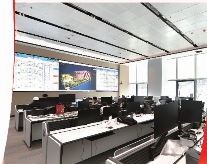
三峡东岳庙数据中心主控室
