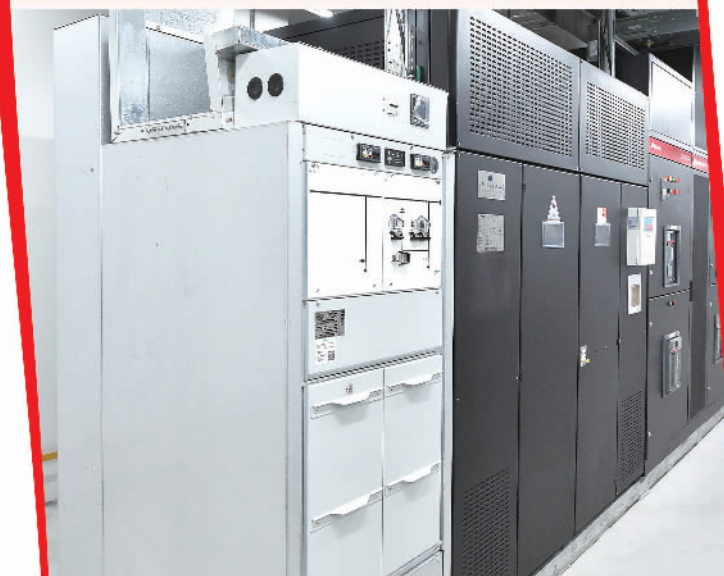
三峡东岳庙数据中心配电室
