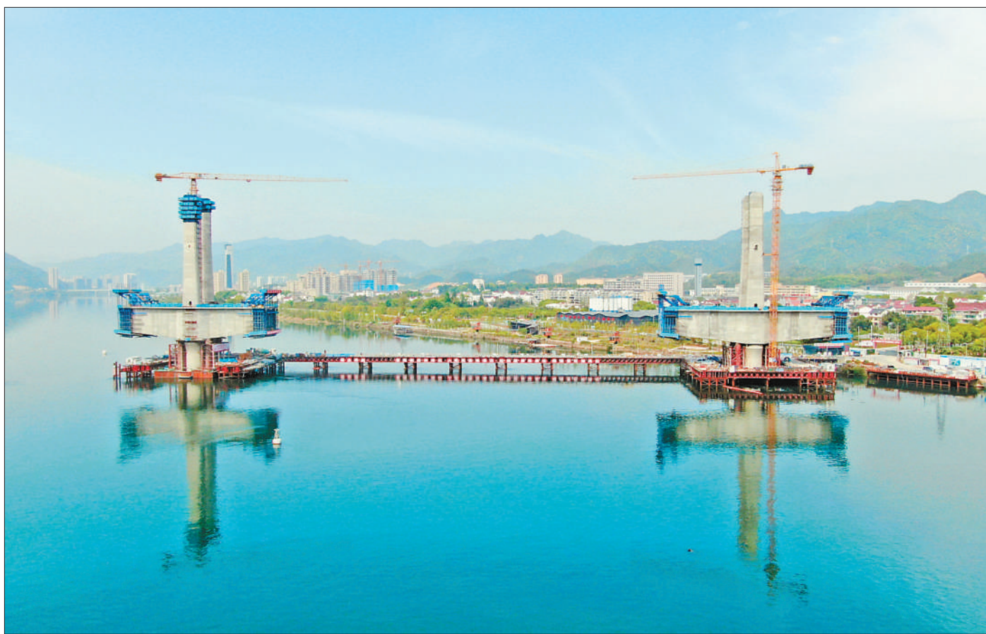
图为建设中的新安江特大桥。吴佳妮 白 洋摄影报道(影像中国)
