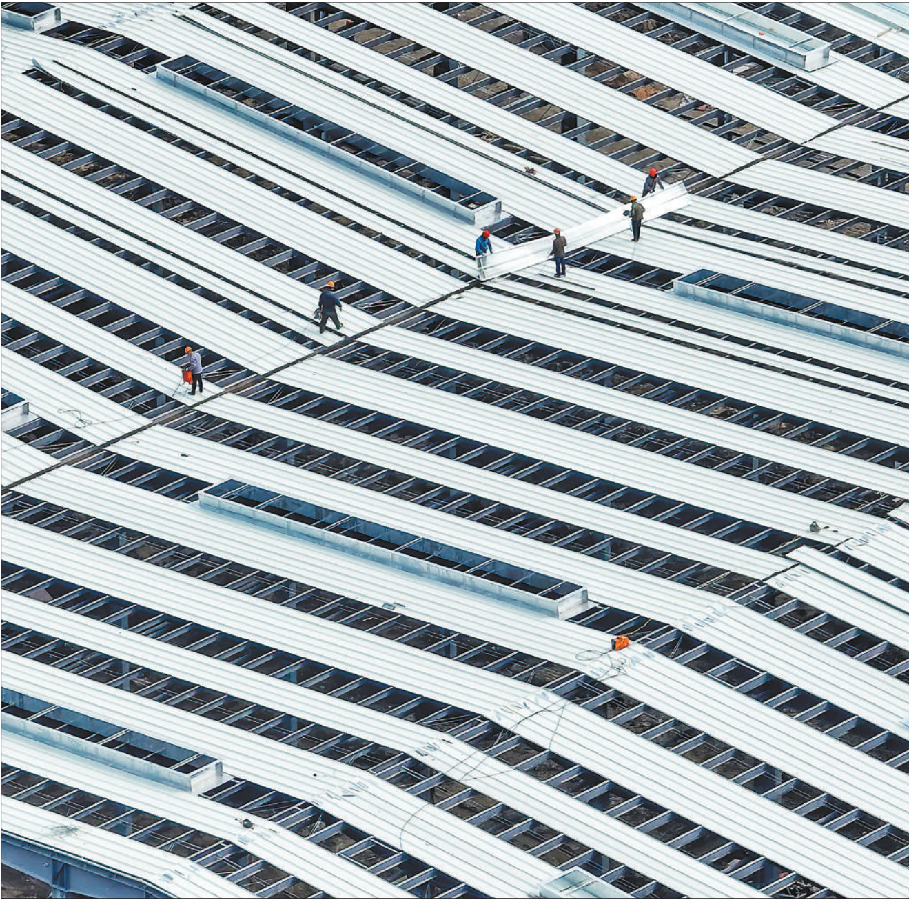
4月1日，安徽肥东县循环经济示范园锂电产业基地项目工地，工人们忙着铺设生产厂房屋顶。近年来，肥东县全面加强建设新能源新材料、光伏光电、大健康大数据、新型交通等战略性新兴产业集群，不断促进经济发展转型升级取得新成效。
