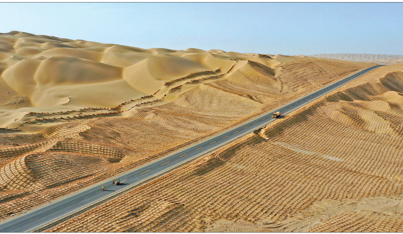
3月26日,新疆尉犁至且末沙漠公路尉犁段施工现场,工人正在道路上划线。尉犁至且末沙漠公路是新疆第三条穿越塔克拉玛干沙漠的公路,建成通车后将带动沿线旅游发展和资源开发。汪志鹏摄(影像中国)
