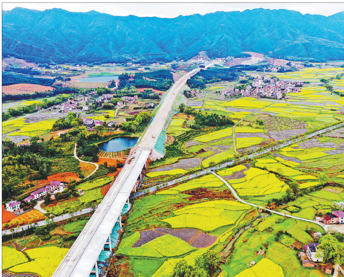
宜遂高速公路总里程约194.5公里，是江西省在建线路最长、施工规模最大的高速公路项目。该项目于2019年12月开工，建设工期为36个月。图为3月17日，建设中的宜遂高速公路江西省吉安市安福县严田镇路段。刘丽强摄（影像中国）
