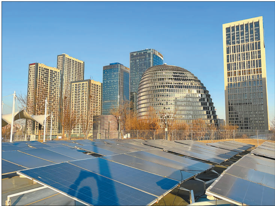
北京冬奥村(冬残奥村)光伏发电现场。
