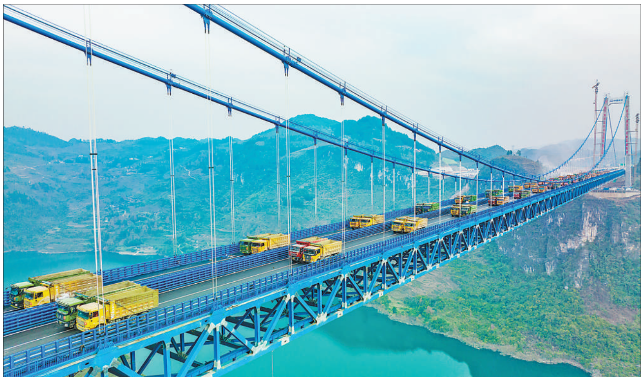
12月9日，总载重2520吨的72辆大货车在贵州省瓮(安)开(阳)高速公路开州湖特大桥进行静力荷载试验，全面检测大桥承载能力。开州湖特大桥横跨洛旺峡谷，项目通车后将惠及瓮安县和开阳县5个乡镇约12万群众。邓刚摄(影像中国)
