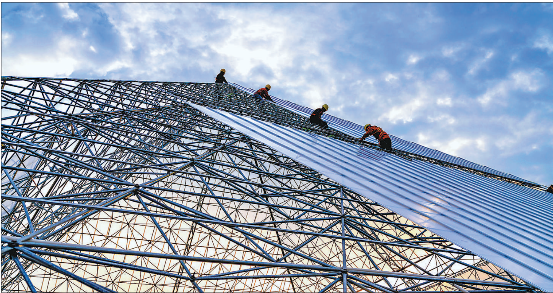
近日，安徽省合肥市肥东县桥头集镇的农业科技示范园建设工地，工人们正在抓紧建设植物工厂温室。该示范园项目是集研发、生产、采摘、观光旅游和农产品仓储、销售、配送于一体的现代农业综合体。近年来，当地加快建设现代农业示范园区，构建乡村产业体系，助力乡村振兴。（阮雪枫摄（影像中国））
