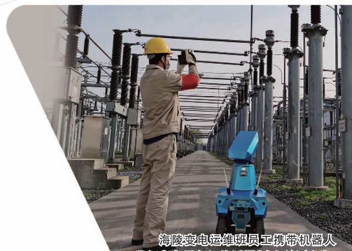
海陵变电站运维班员工携带机器人进行变电设备红外测温(人机双验证)
