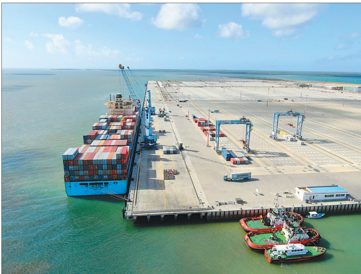
近日,位于肯尼亚曼达湾的拉穆港1—3号泊位加快建设运营进度。该项目由中国交通建设股份有限公司承建,主体施工计划于12月完成。图为1号泊位作业现场。 中国交通建设股份有限公司供图
