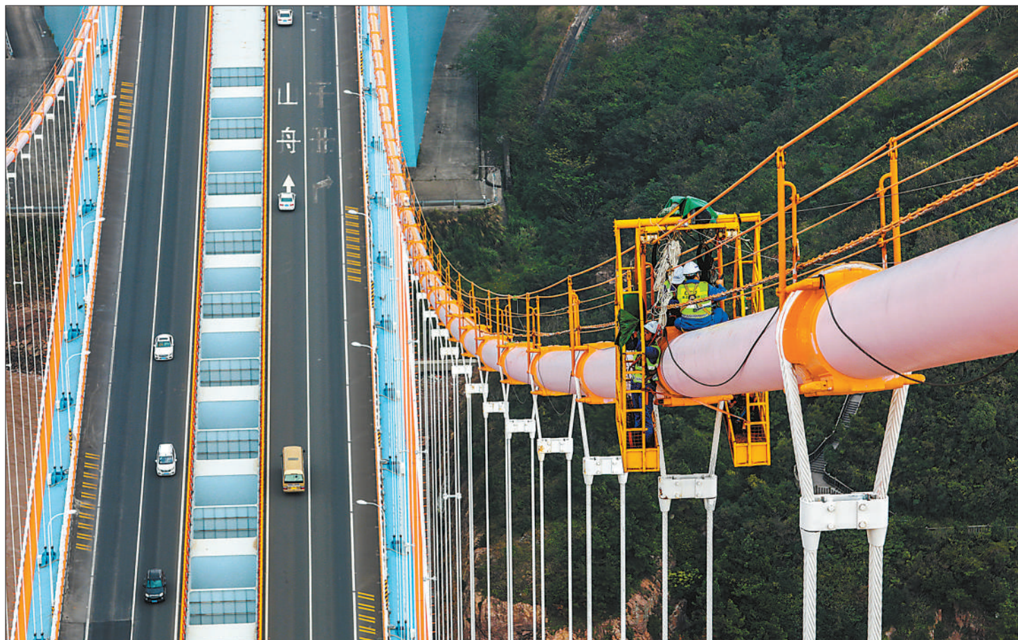
10月19日,浙江舟山跨海大桥之一的西堠门大桥主缆上,养护工人对大桥主缆吊索进行检修作业。西堠门大桥全长2.588公里,主桥为主跨1650米的两跨连续钢加劲梁悬索桥,北边跨及中跨为悬吊结构,塔高211米。为消除因长期运营过程中可能产生的紧固件松动等隐患,确保大桥运营安全,浙江省交通集团高速公路舟山管理中心专门开展检修工作。
