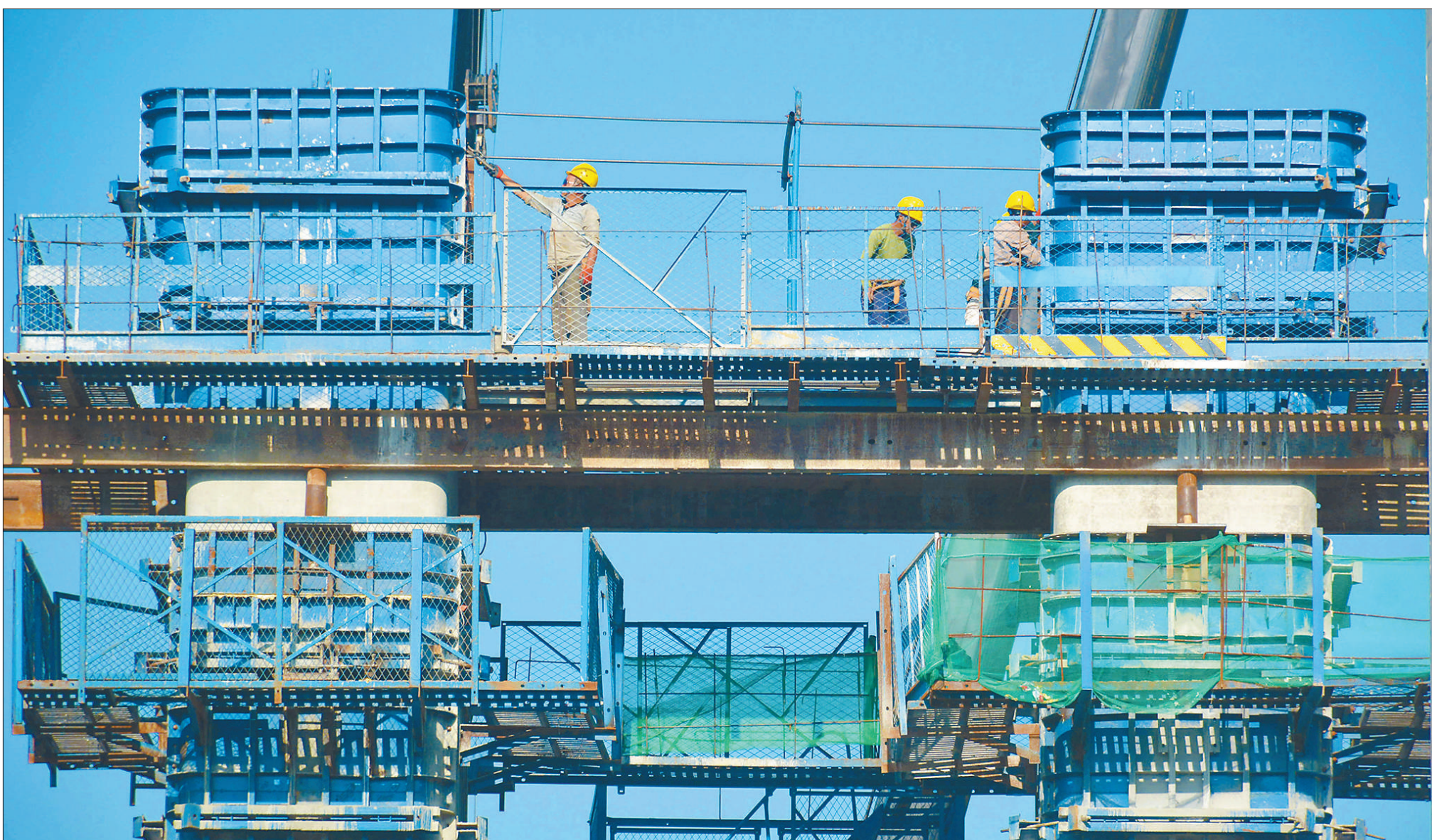
10月6日，G42S上海至武汉高速公路无为至岳西段，工人们正在建设安徽省安庆市岳西县境内的衙前河大桥。国庆假期，建设者坚守岗位，保证项目如期推进。
