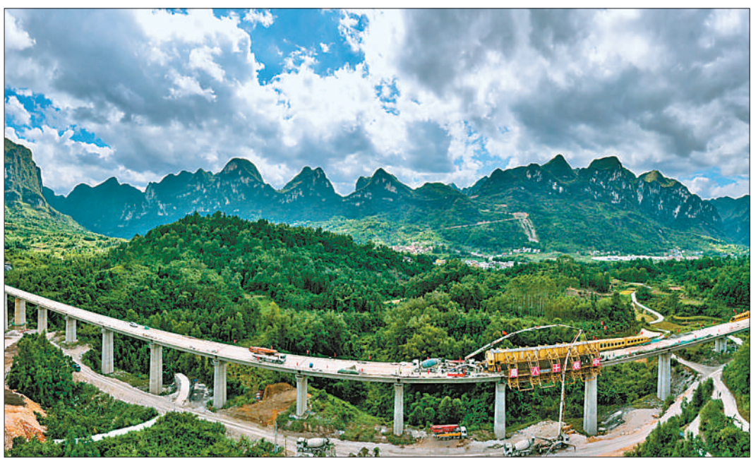
9月16日,贵(阳)南(宁)高铁捞捞村双线特大桥顺利合龙。大桥位于贵州省荔波县境内,全桥长2138米,最高墩达49米。图为正在进行最后混凝土浇筑的捞捞村双线特大桥。新华社记者 刘 续摄
