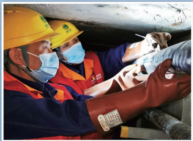
供电工作人员对电缆设备进行日常检查
