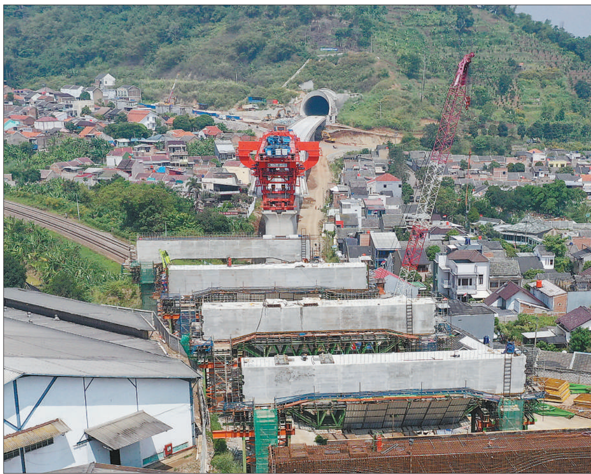
图为日前,雅万高铁万隆段跨既有铁路箱梁架设工程现场。
