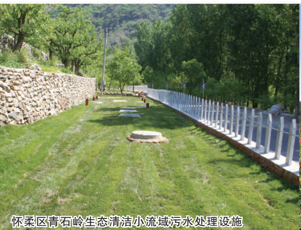
怀柔区青石岭生态清洁小流域污水处理设施
