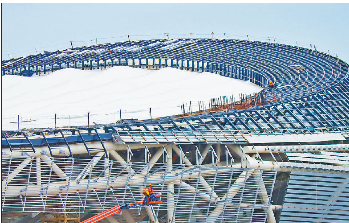
8月29日,四川省乐山市奥林匹克中心项目工地,工人抢抓晴好天气加紧建设。乐山市奥林匹克中心是2022年四川省第十四届运动会主场馆,项目占地面积约339亩。杨飞摄(影像中国)
