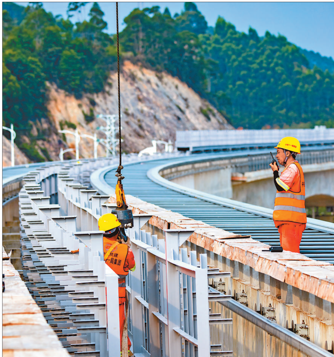
七月二十九日，在广东首条中低速磁浮线——清远磁浮旅游专线项目现场，建设者顶着烈日、战高温，进行磁浮疏散平台施工。广东清远磁浮旅游专线项目全长约三十八公里，分两期建设，供中低速磁浮列车行驶。金伟摄（影像中国）
