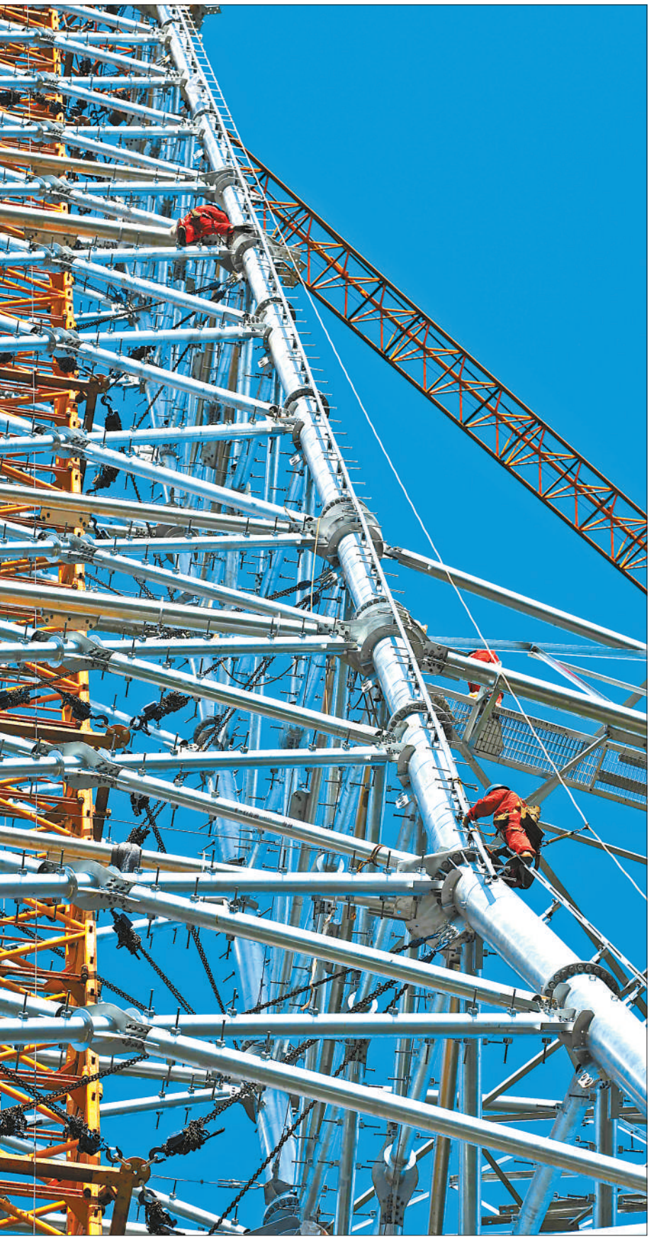
近日,江西省万载县三兴镇红旗村,工作人员顶酷暑组装1000千伏特高压电网铁塔。今年以来,南昌至长沙1000千伏特高压交流线路工程有序推进,该工程将实现江西、湖南电网互联。
