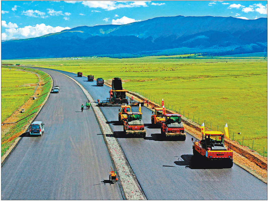
7月25日,筑路工人在G575线新疆哈密松树塘路段铺油。经过近5年的建设,新疆G575线巴里坤至哈密公路建设项目雏形渐显。目前,全线路基和桥梁工程全部完成,路面工程完成80%以上,预计在年底通车。该公路是《国家公路网规划》的重要组成部分。蔡增乐摄(影像中国)
