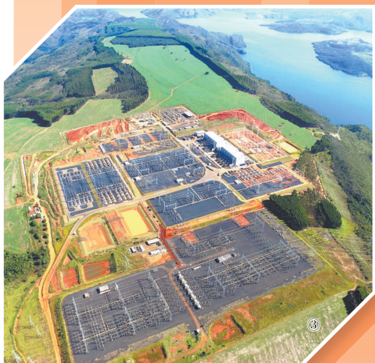
图③：国家电网巴西控股公司参与投资建设了巴西美丽山一期特高压直流输电工程，图为该工程受端换流站伊斯特雷雷都站。
