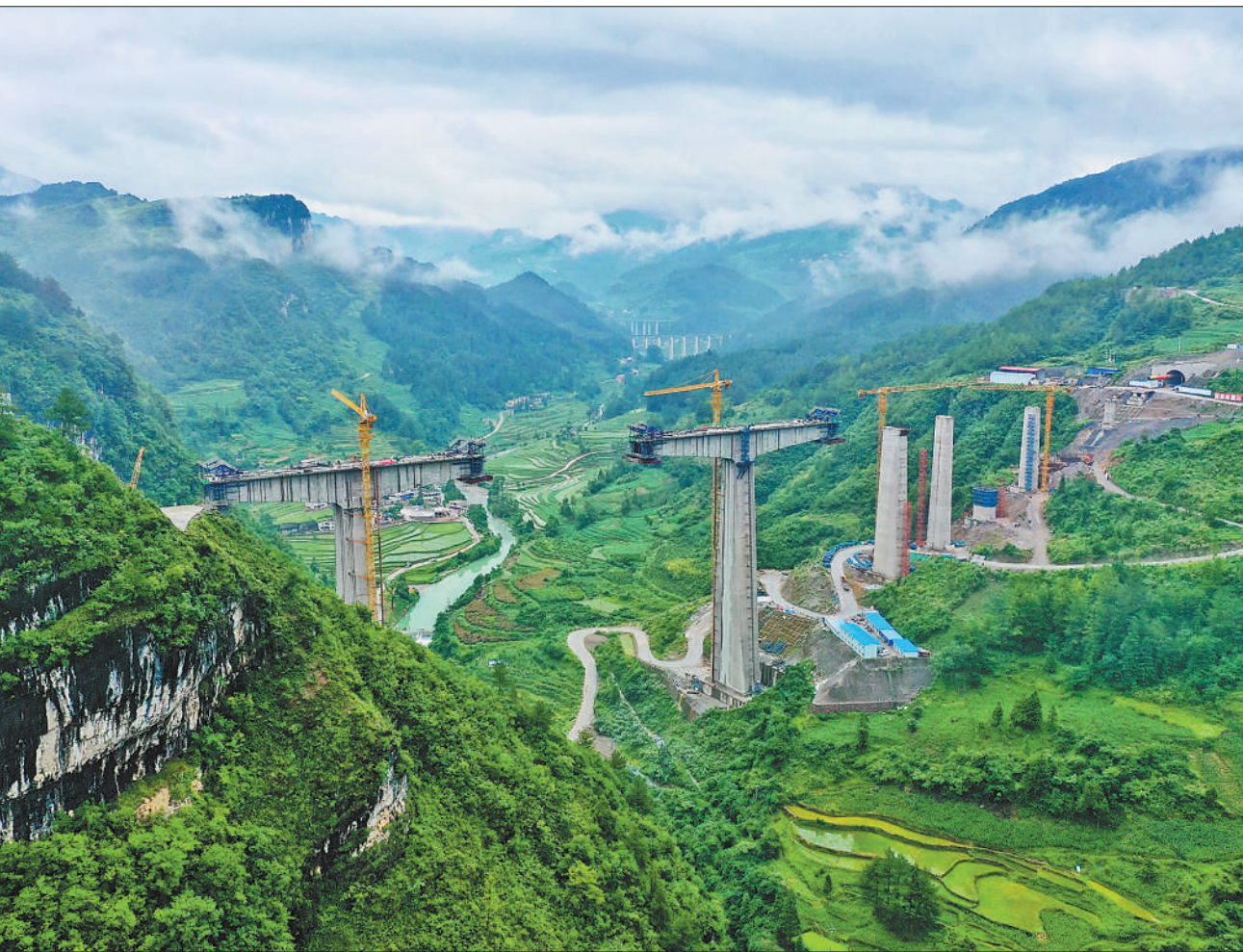
目前,贵(贵阳)南(南宁)高铁施工进度顺利。贵南高铁设计时速350千米,是我国“八纵八横”高速铁路主通道包头至海口通道的重要组成部分。图为位于贵州省贵定县的桐子园双线特大桥施工现场。
