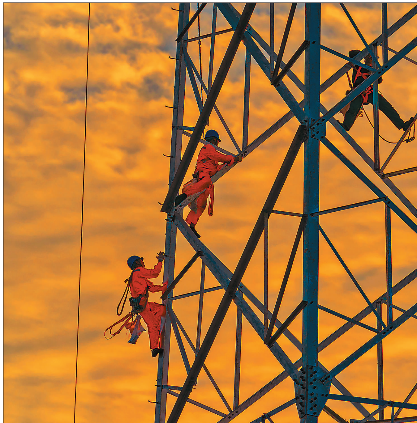
白鹤滩—江苏±800千伏特高压线路(南京段)是南京地区首条特高压线路。这一项目对实施“西电东送”国家战略、推动我国清洁能源大范围优化配置和解决江苏省“十四五”电力供应紧缺局面具有十分重要的意义。
