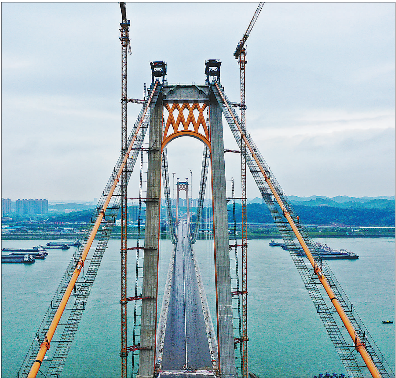
5月16日,湖北省宜昌市伍家岗长江大桥完成主体工程,进入配套工程施工。伍家岗长江大桥是宜昌市的第九座跨江公路大桥。为了保护长江珍稀鱼类,该桥采用主跨1160米悬索桥一跨过江的方案,与三峡翻坝高速公路相衔接。
