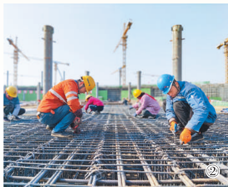
图②:2月17日,在山东省菏泽市鲁南高铁菏泽东站施工现场,工人们正在作业。李保珠摄(影像中国)
