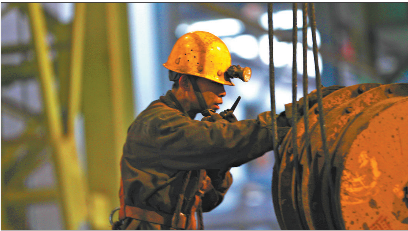
内蒙古兴安盟某钢铁企业的设备维修人员正在对吊运起重电磁铁设备进行巡检维护。
